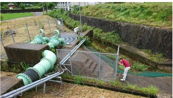
三重県紀宝町・内水対策用ポンプ
