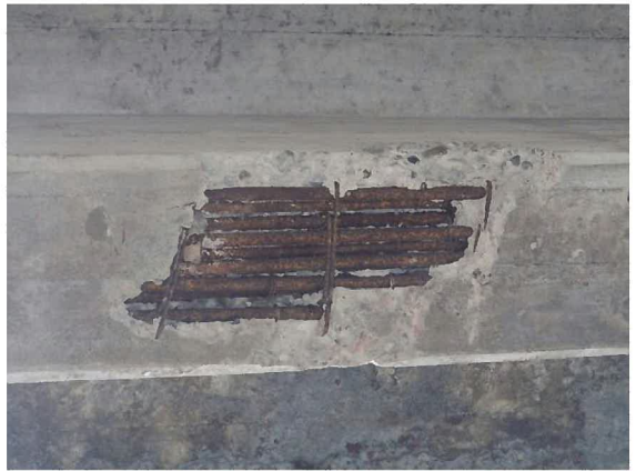
コンクリート桁の剥離・鉄筋露出
