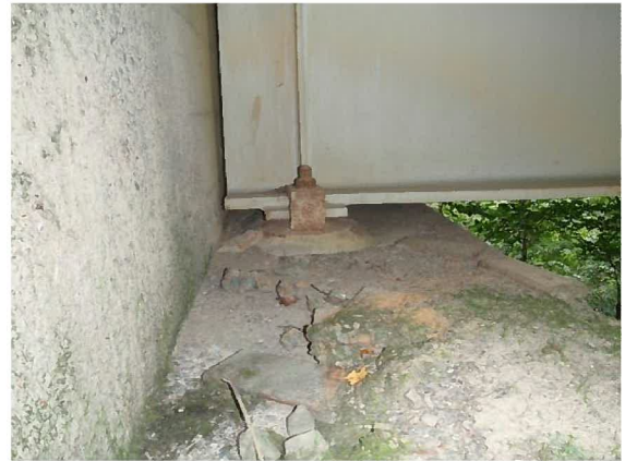
支承の機能障害
