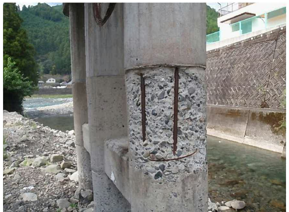
コンクリート橋脚の剥離・鉄筋露出
