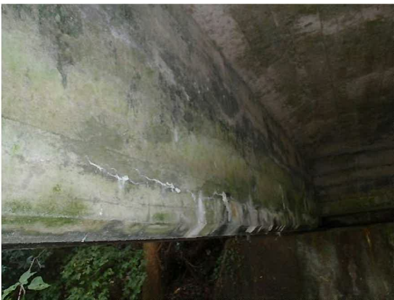
コンクリート桁のひびわれ・遊離石灰
